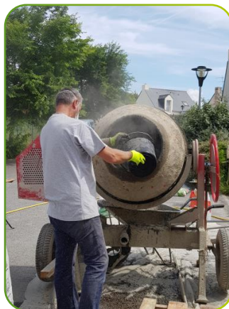
Verser 6 litres d'eau (seau gradué)
